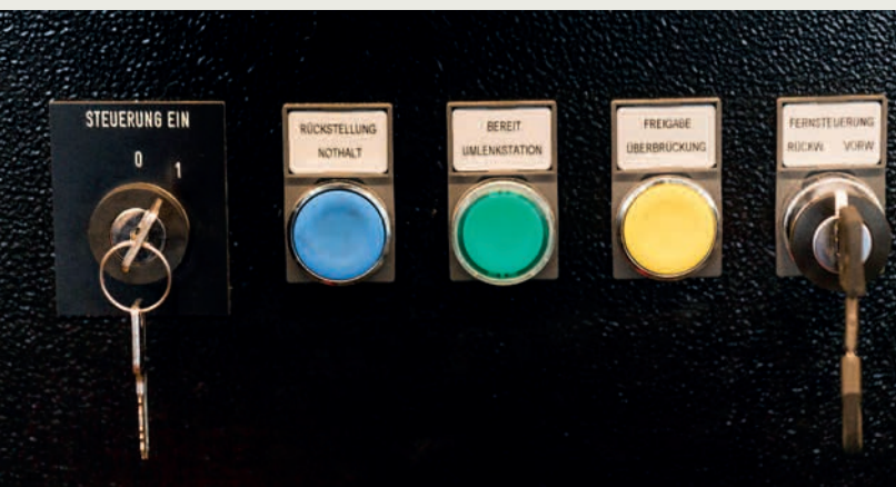
Steuerung Transportanlage, © Weisse Arena Gruppe, Gaudenz Danuser
