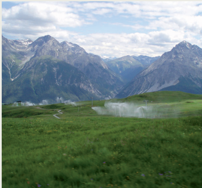
Systemtest bei Bauabnahme, Bergbahnen Motta Naluns Scuol-Ftan-Sent AG
